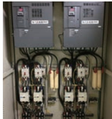
インバータ制御盤
