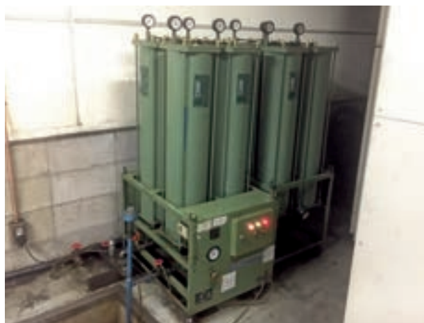
ドレン処理装置
