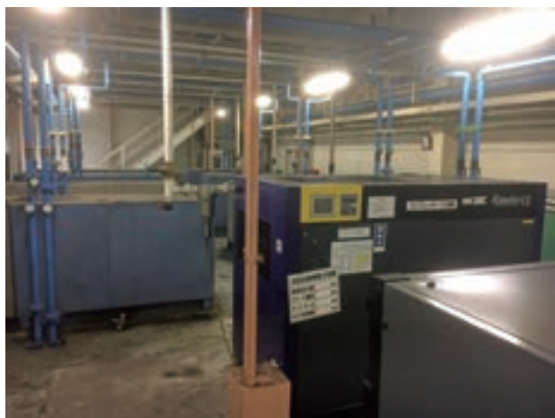
コンプレッサー室
